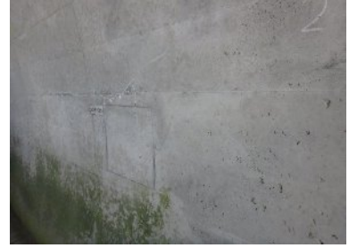
・打ち重ね線に沿ったひび割れあり。締固め管理不足が原因か？
