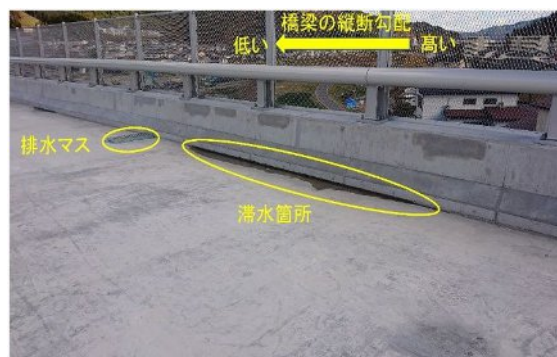
写真-2.4.1.9 床版の平坦性不足による滞水の例
