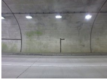
・坑口から1～2スパンに目地補修・拘束ひび割れ補修・水平打ち重ね線補修あり
