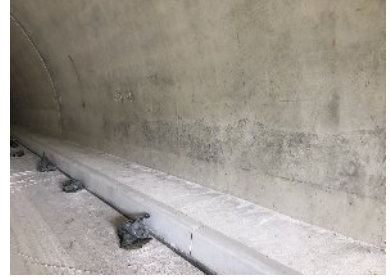
・【良好事例】SLより下部にビニールシート養生の跡がある。
