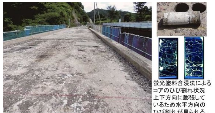
写真－2.4.17 ASR を起こした RC 床版の状況
