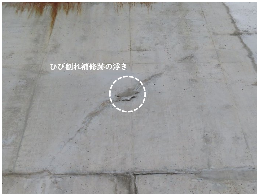
写真-2.5.2.21 上記写真 右上のひび割れ（接写）
