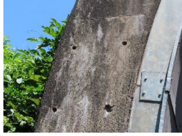
・坑門工にASRIによるひび割れ？
