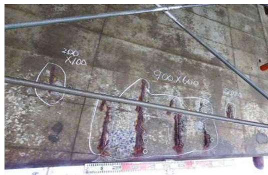
写真-2.3.1.3 鋼材のかぶり不足
