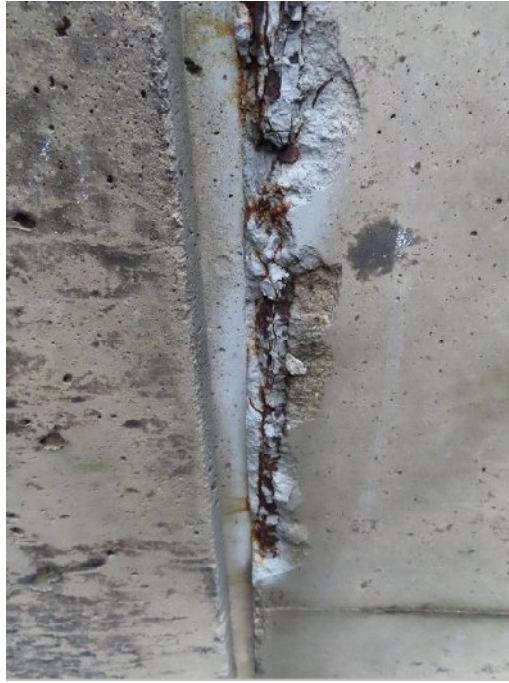
写真－2.4.2.4 塩害・凍害の複合劣化が発生した事例（施工目地部）
