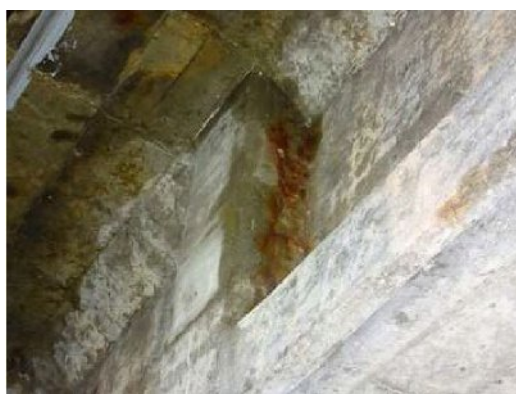
写真-2.5.1.10 横締め定着部の不具合の事例
