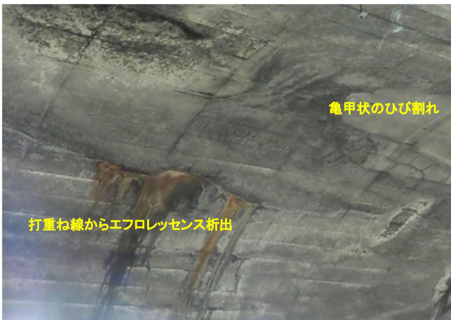
写真－2.5.4.2 1980年代の覆工の不具合事例
