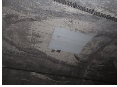
・断面修復跡あり。 ・はく落防止ネットあり。
