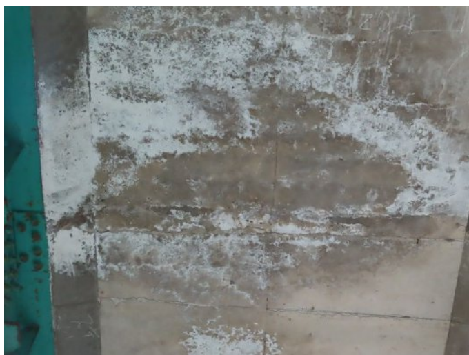
写真-2.5.3.3 打設ブロック境界からの漏水事例
