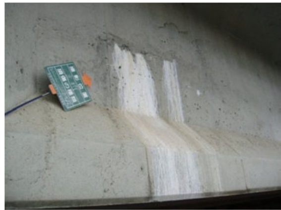
写真-2.5.1.9 PC鋼材に沿ったひび割れの事例
