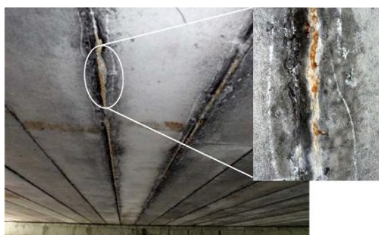
写真 2.5.1.2 間詰め部からの漏水の例
