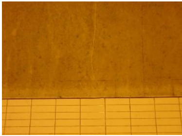
・側壁中央に拘束ひび割れあり。
