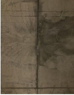
・目地の一部に強度不足によるうきがある。
