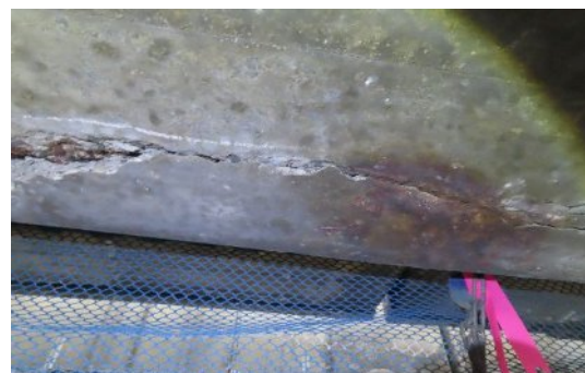
写真-2.3.1.4 ひび割れ部の鋼材の腐食
