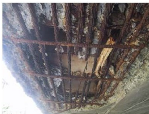
写真-2.3.1.5 塩害による上部構造の劣化 (山間部の橋梁)
