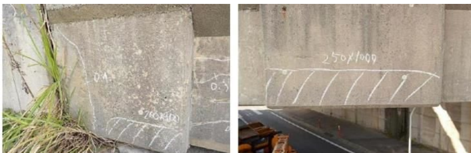
写真-2.5.1.5 横桁定着部のうきの例
