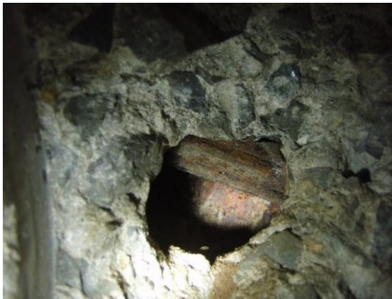
写真-2.5.1.8 シース内部のグラウトの充填不良の事例
