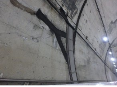
・ひび割れ補修あり。漏水導水あり。 ・エフロレッセンス漏出あり。
