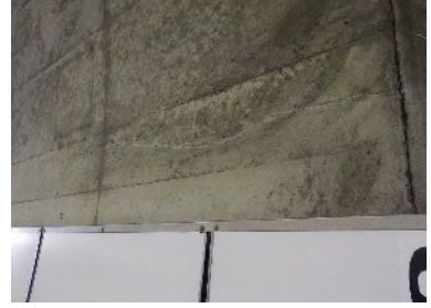
・側壁の打ち重ね線にひび割れあり。
