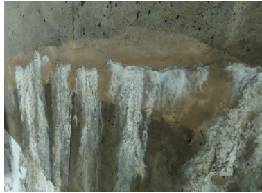
・打ち重ね線のひび割れからエフロレッセンス漏出あり。
