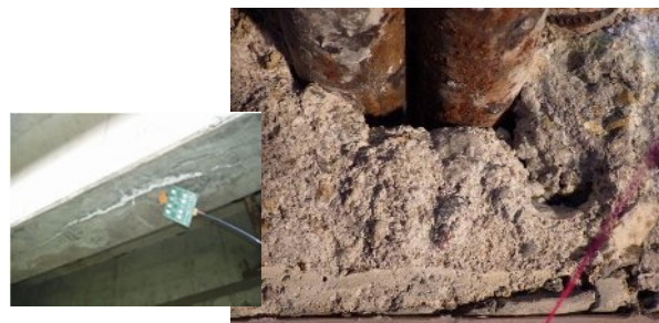
P C T桁橋の材料劣化事例
