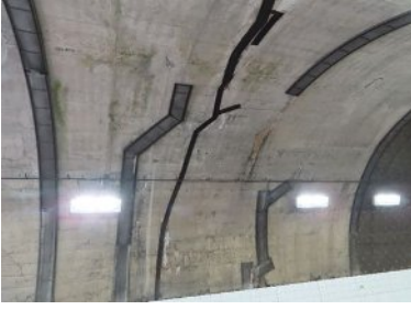
・インパート拘束によるひび割れや施工不良によるひび割れが繋がって発生している。
