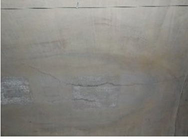
・天端縦断方向ひび割れ。
