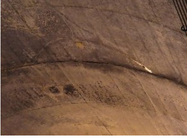
・セントララップ部分に半月状のひび割れ。
