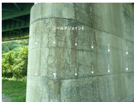
下部構造の材料劣化事例
