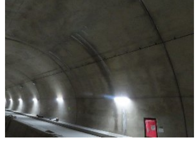
・打ち重ね線のひび割れからエフロッセンス漏出あり。
