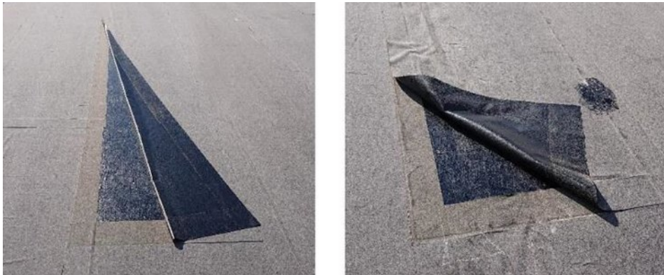
写真-2.4.1.6 防水シートのオーバーラップ部分に生じた剥がれ
