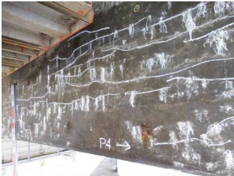
写真-2.3.2.4 飛来塩分の影響を受けたPC箱桁のASRの事例
