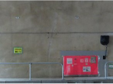
・インパート拘束によるひび割れあり。
