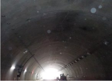
・打設初期のスパンの天端に縦断方向ひび割れが多数あり。
