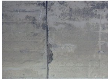
5. 施工目地不良
