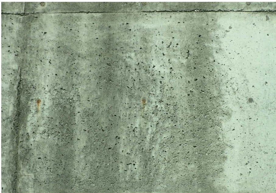
写真-2.5.2.17 I 橋の面全体に発生した表面気泡
