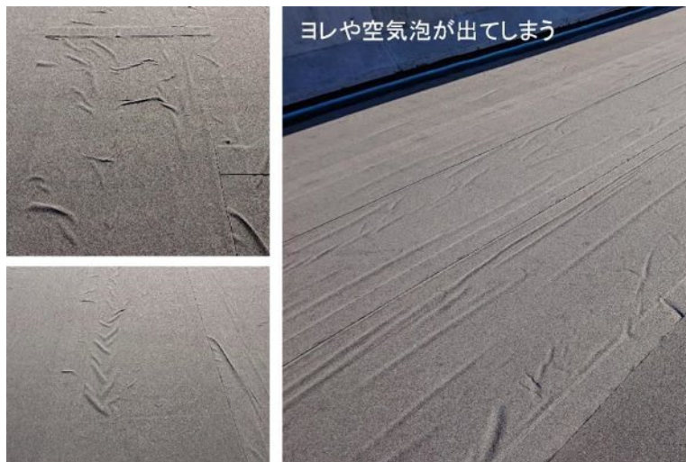
写真-2.4.1.4 床版の防水シート施工時に生じたヨレなどによる空気泡
