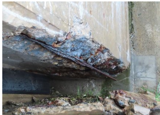
写真-2.3.1.2 塩害の事例（山間部の橋梁）
