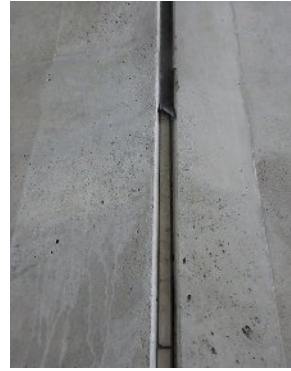
・台形目地にゴム系の充填が実施されている。
