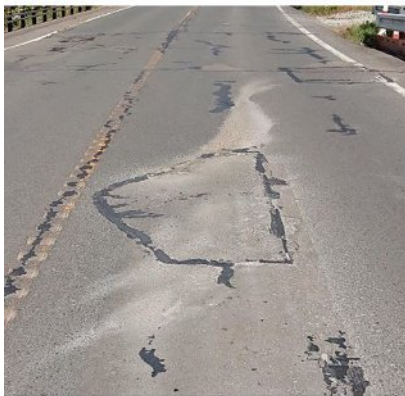
舗装補修箇所からの噴出物
