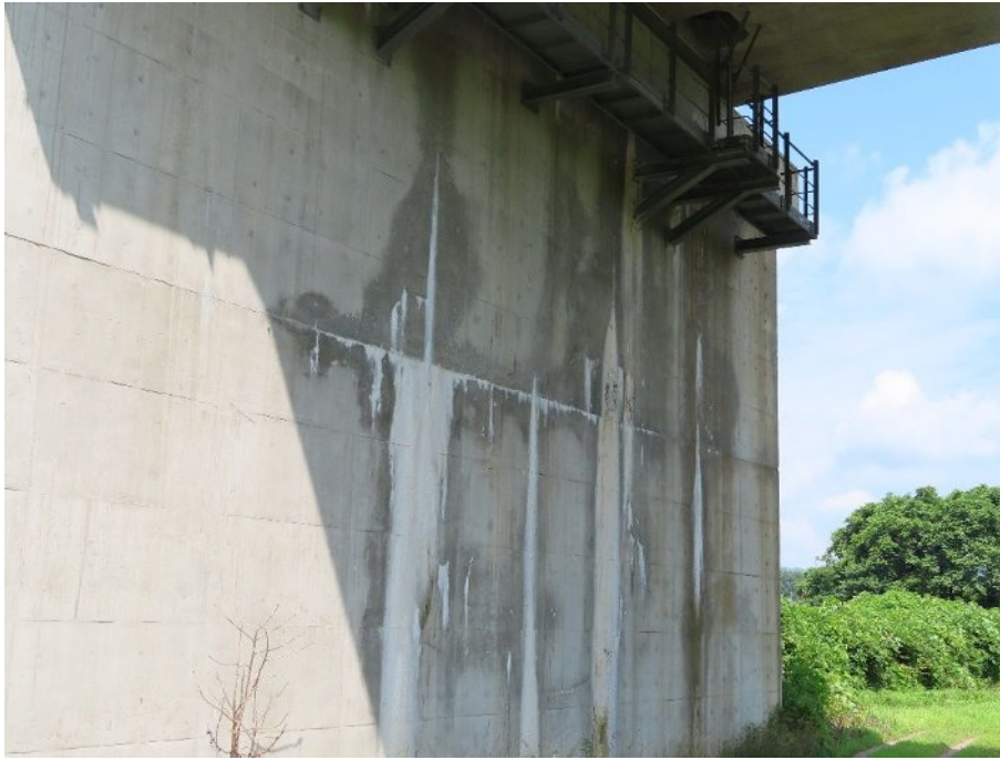
写真-2.5.2.2 打継ぎ箇所からエフロレッセンスの析出
