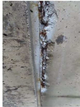
うき・はく落に発展し、鉄筋に腐食が発生 ⇒耐久性の低下
