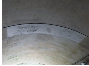
・天端ラップ側に補修跡あり。
