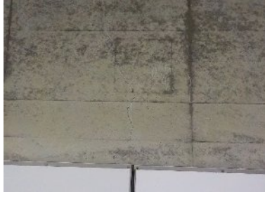
・ひび割れ幅0.55mm。
