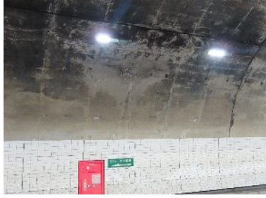
・側壁ひび割れからエフロレッセンス漏出あり。
