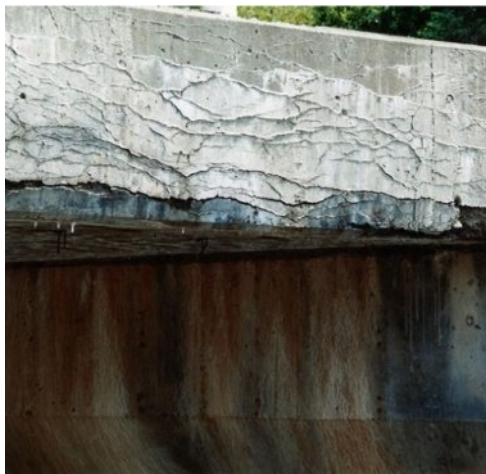
写真-2.3.3.1 内部損傷
