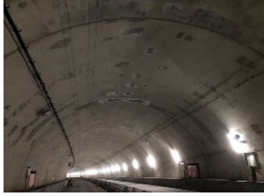
・天端の検査窓、吹き上げ口付近に補修跡あり。
