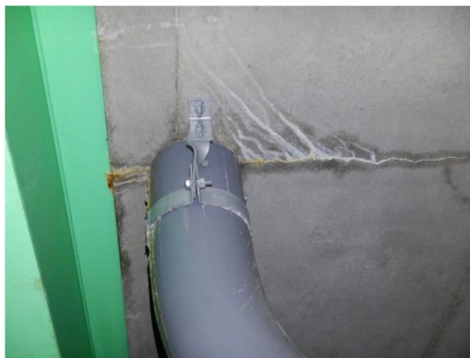
写真-2.5.3.6 排水柵部のひび割れ事例
