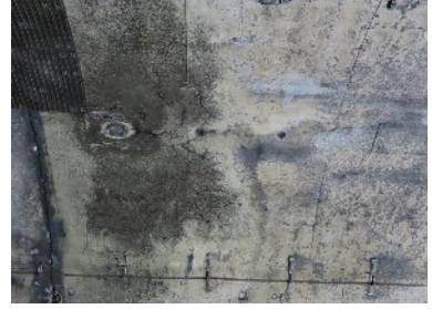
・天端吹き上げ口付近の亀甲状のひび割れ。
