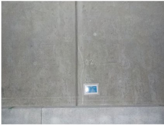
目地部に生じたひび割れが
