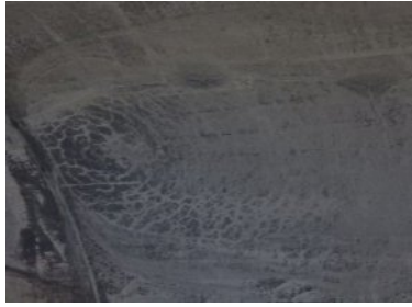
・天端部に亀甲状ひび割れあり。
