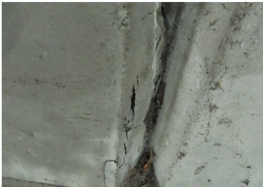
写真-2.4.2.1 施工目地不良がはく離・はく落に進展した事例
