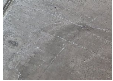
・天端のながれ縞に沿ってひび割れあり。
