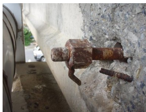
写真-2.5.1.11 PC鋼材が突出した事例
