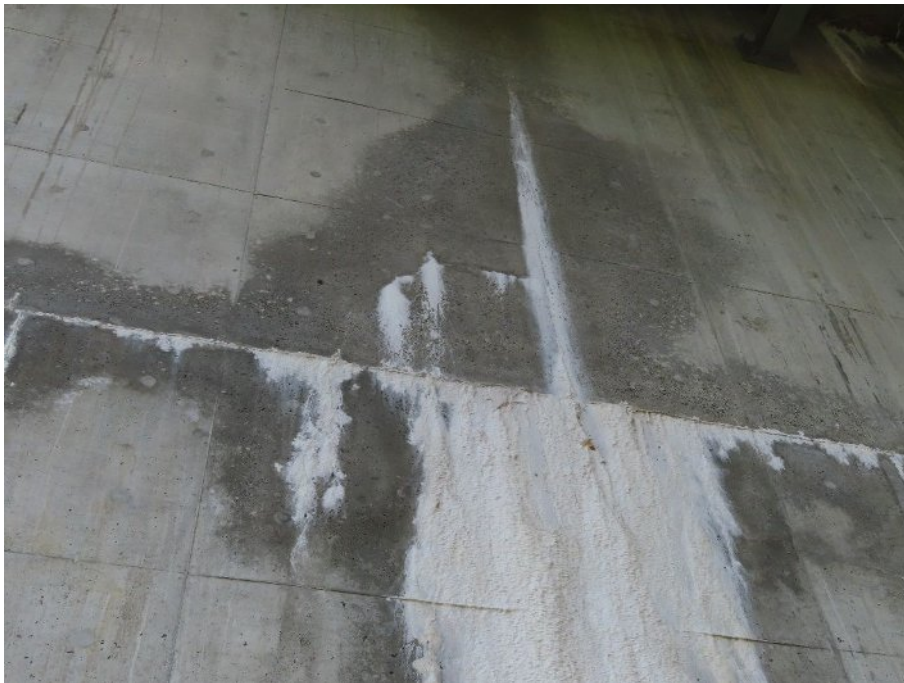
写真-2.5.2.3 打継ぎ箇所からエフロレッセンスの析出（接写）
