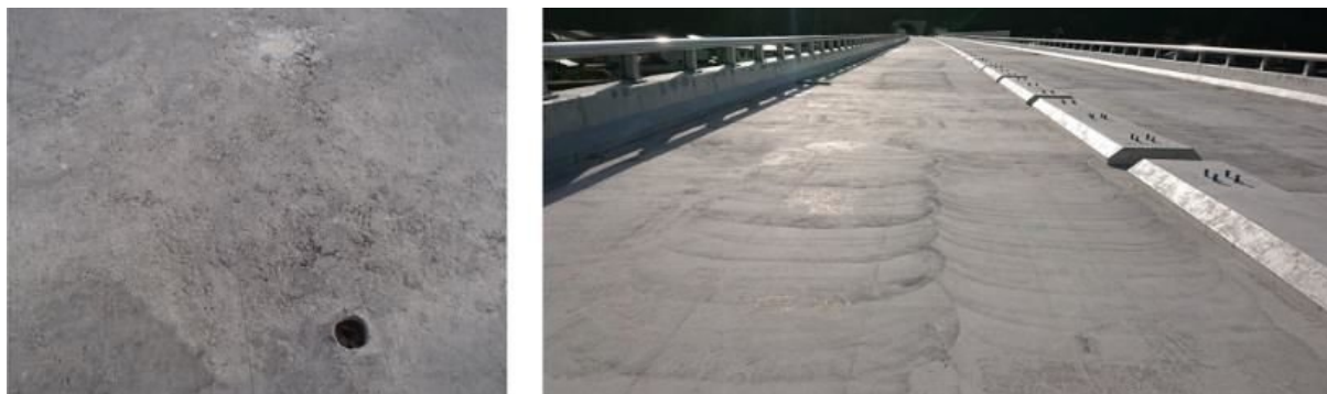
写真-2.4.1.8 床版の仕上げ不良の例
