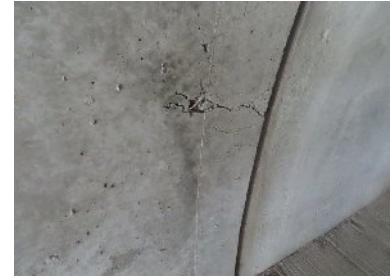
・目地部にアラミド繊維補強が実施されているが、締固め不良や充填不足によるジャンカが多数ある。
