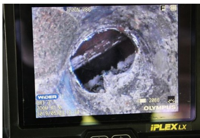
写真－2.2.1.2 シース管内部の充填不良
