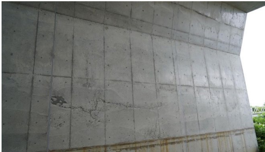
図-1.1 コールドジョイント，砂筋，不適切な打ち重ね(ボックスカルバート側)
