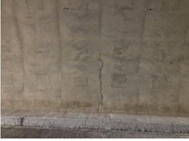
・拘束ひび割れ補修跡あり。
