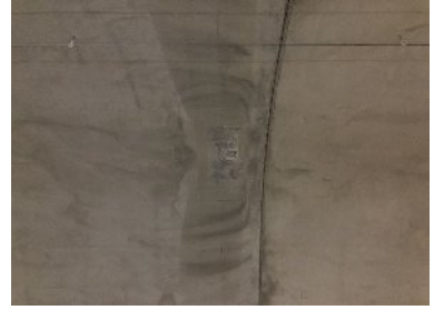
・天端吹き上げ口付近のはく離。
