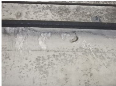
・かぶり不足で鉄筋が露出している。
