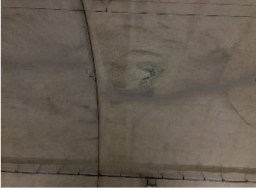
・天端吹き上げ口周辺にコールドジョイントあり。
