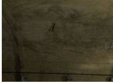
・天端吹き上げ口付近に大規模なコールドジョイントあり。
