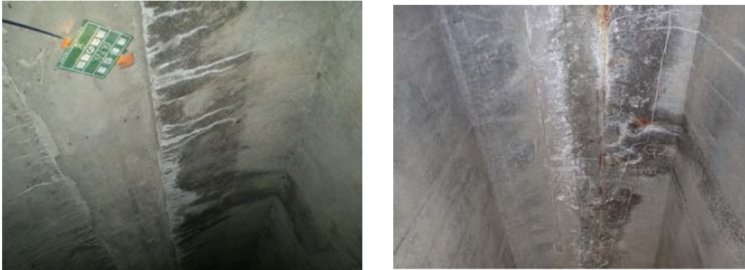
写真-2.5.1.7 間詰コンクリートの不具合の事例
