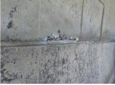
・鉄筋の露出あり。かぶり不足。
