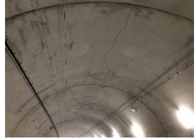
・天端軸方向にひび割れ補修跡あり。
