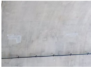
・目地からのにじみ。 ・検査窓枠にジャンカあり。
