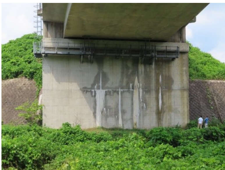
写真-2.5.2.1 打継ぎの不具合の A1 逆 T 式橋台
