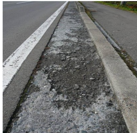
写真-2.3.3.2 表面損傷
