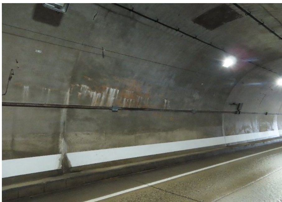
写真-2.4.2.2 打重ね線がひび割れに進展した事例
