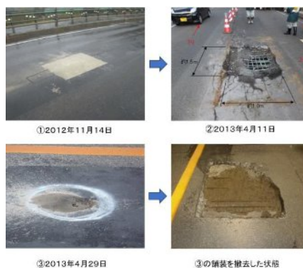
写真－2.4.1.13 砂利化の発生状況
