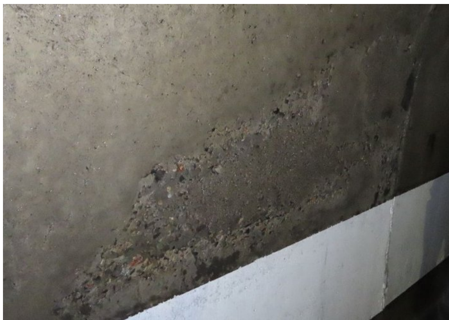
写真-2.4.2.3 凍害が発生した事例 (施工目地部付近の脆弱部)
