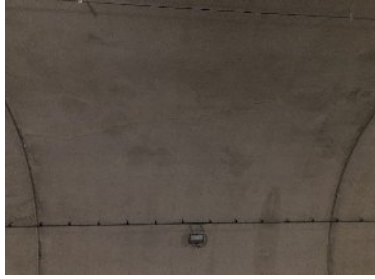
・天端の流れ縞に沿ったひび割れ。
