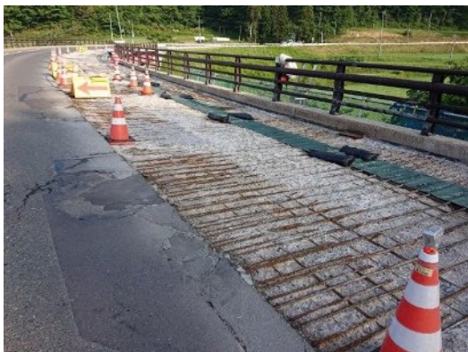
写真－2.4.16 砂利化を起こした RC 床版の鉄筋の腐食状況
