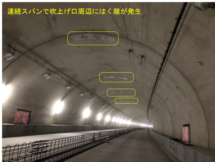
写真－2.5.4.18 連続スパンでの不具合発生事例
