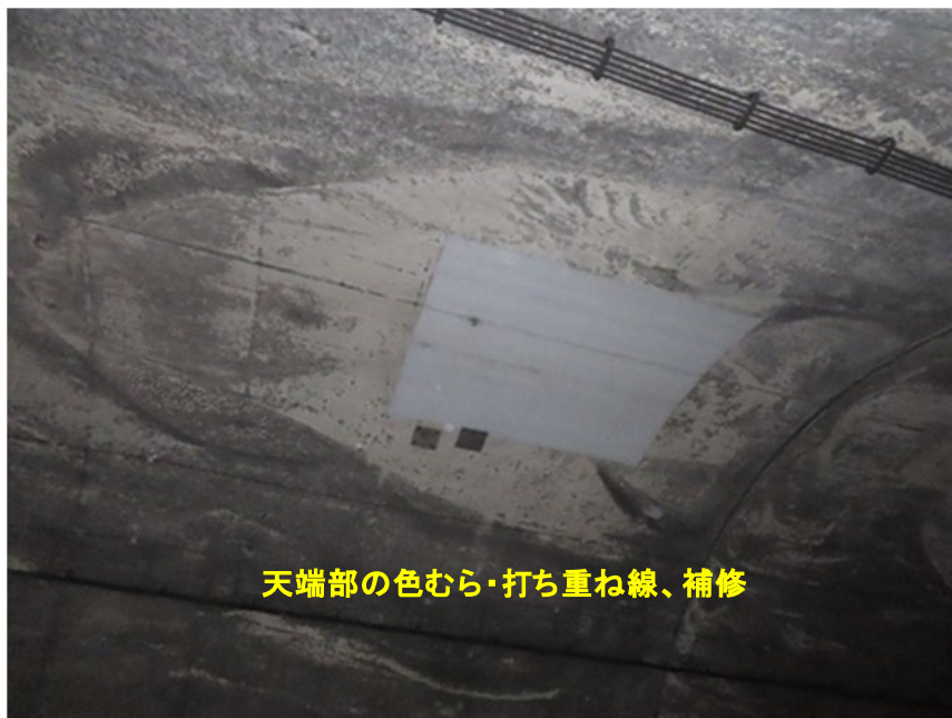
写真-2.5.4.4 1990年代の覆工の不具合事例
