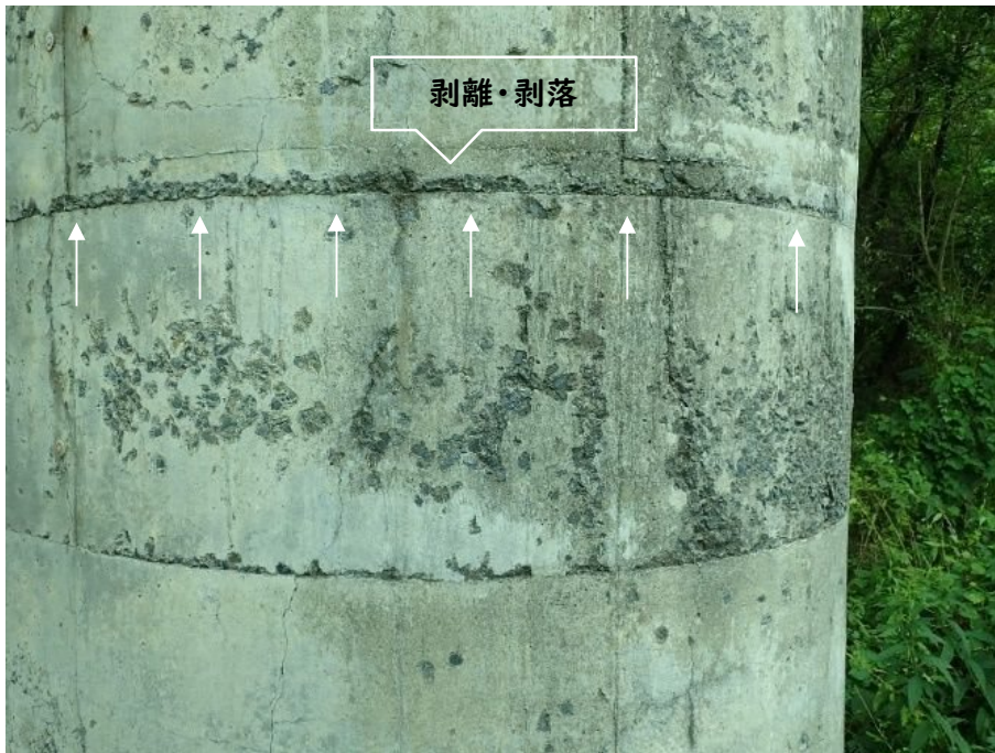
写真-2.5.2.5 打継ぎ箇所のひび割れ，剥離・剥落
