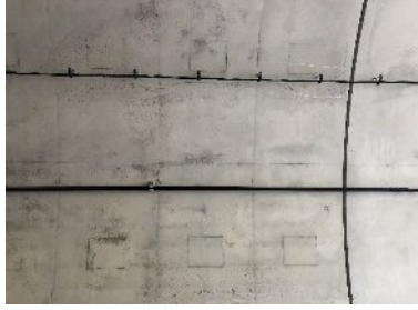
・側壁の打ち重ね線に沿ったうきあり。
