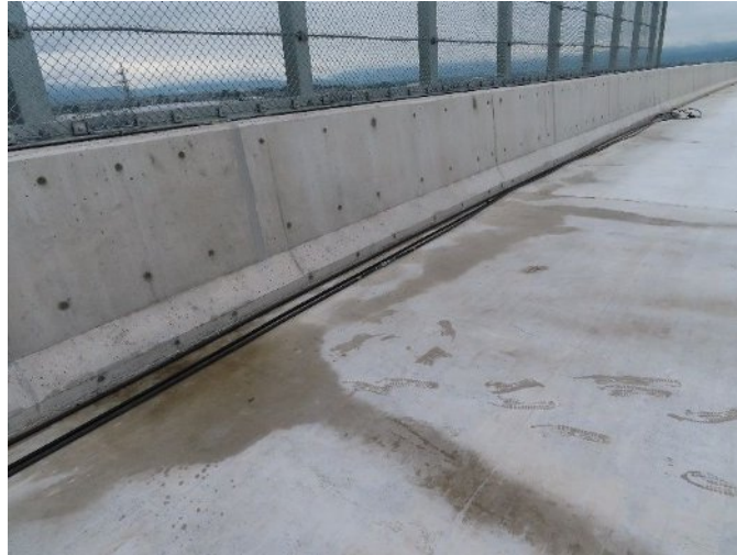
写真-2.5.3.8 床版上面の平坦性の不具合
