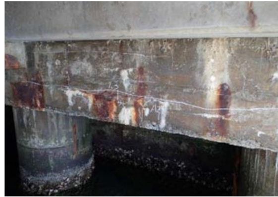
写真-2.3.1.1 塩害の事例（汀線付近の橋梁）
