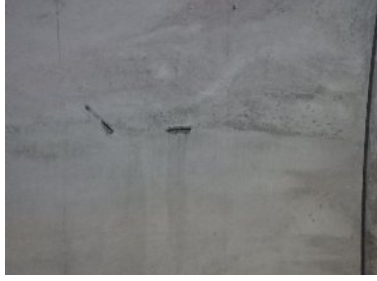
・鉄筋露出あり。
