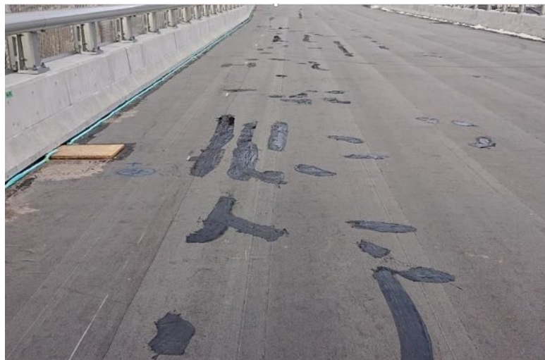
写真-2.4.1.5 防水シートに生じた空気泡をカッターで穴をあけた後加熱アスファルトで補修した状況
