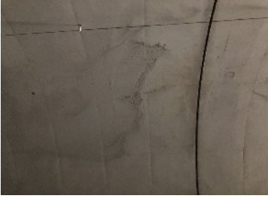
・天端に締固め不足による弱部あり。
