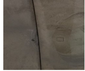
・天端ラップ箇所に半月状のひび割れあり。
