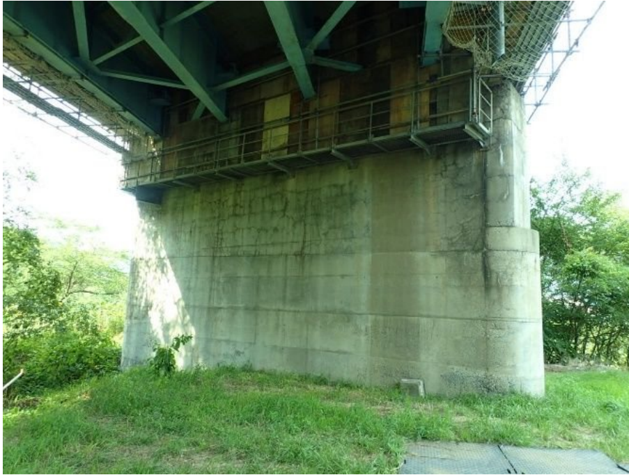
写真-2.5.2.4 打継ぎの不具合のP2 壁式橋脚
