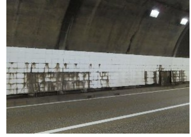
・内装板の裏から漏水が発生している。
