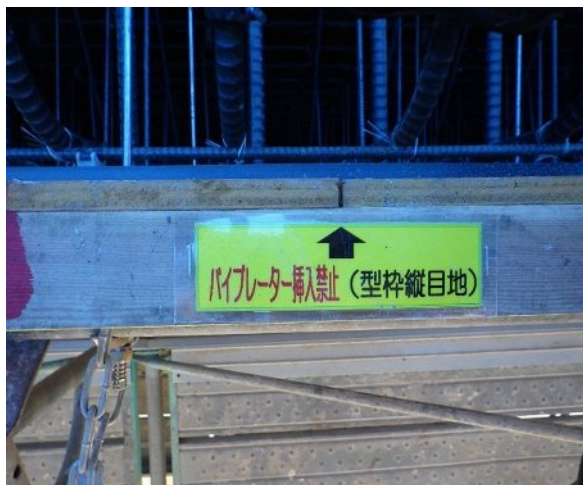
写真－2.5.2.33 バイブレータ挿入禁止の目印
