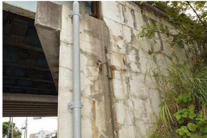
写真-2.3.2.1 橋台に発生したASRの事例
