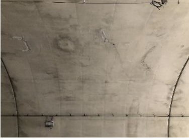
・天端吹き上げ口付近のコールドジョイント。
