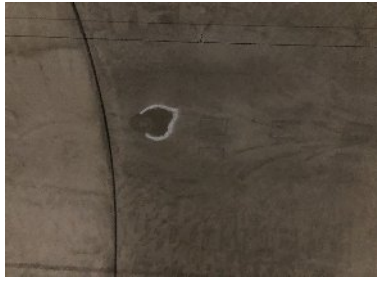
・一部の吹き上げ口周辺にひび割れあり。
