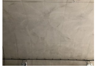
・天端に放射線状のパイプレータ跡あり。
