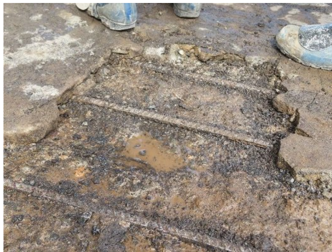
写真-2.5.3.9 床版の土砂化の事例
