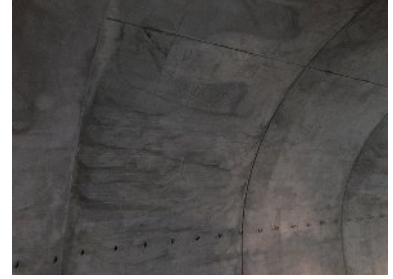
・非常駐車帯では打ち重ね線が明瞭にある。
