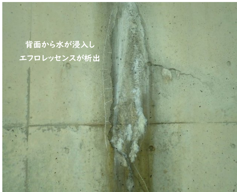
写真-2.5.2.19 上記写真 左側のひび割れ（接写）
