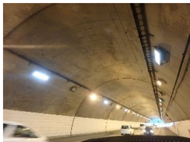
・天端に不規則に検査窓を設置している。
