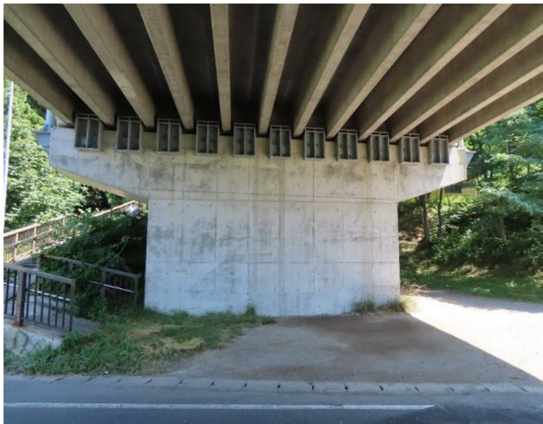
写真-2.5.2.6 打重ねの不具合のP7張出橋脚
