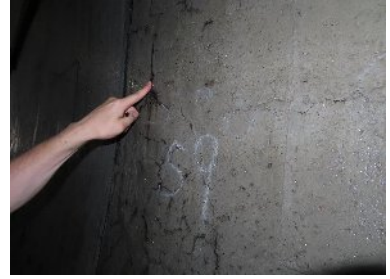
・締固め不良による微細なひび割れが多数ある。
