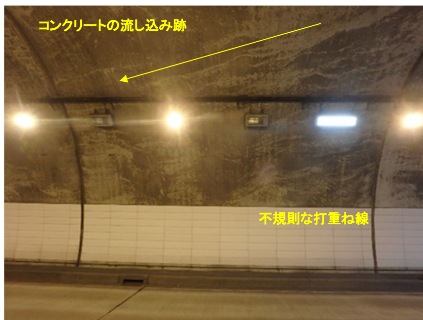
写真-2.5.4.6 2000年代の覆工の不具合事例
