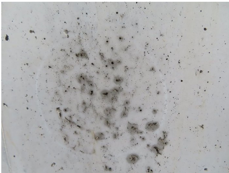
写真-2.5.2.15 H橋の面全体に発生した表面気泡（あばた）
