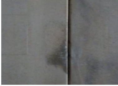
・一部の目地に湿りあとあり。 ・一部の目地にエフロレッセンス漏出？あり。
