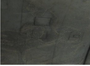
・天端吹き上げ口付近に不規則なひび割れあり。
