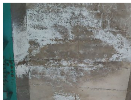
R C床版の材料劣化事例
