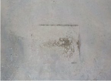
・検査窓付近に亀甲状のひび割れあり。
