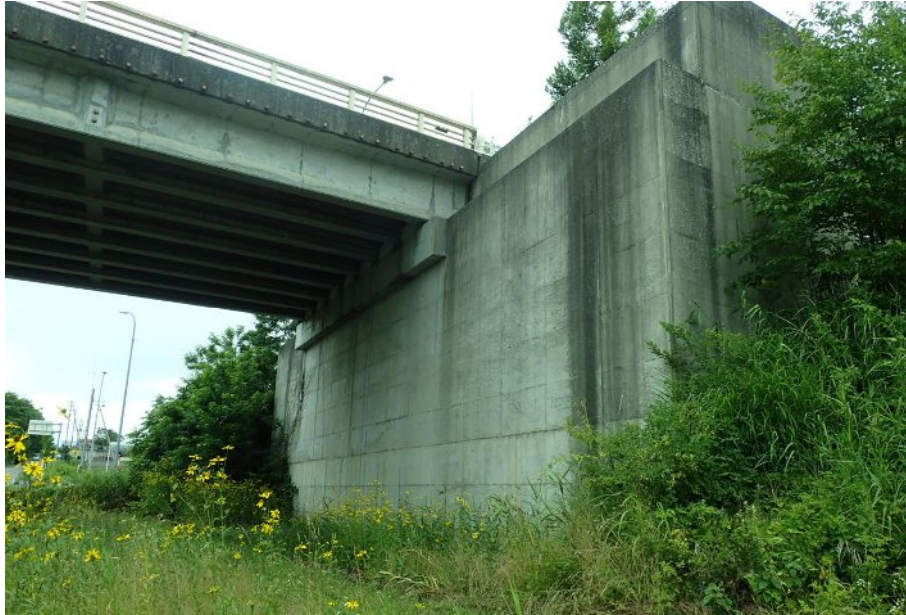
写真-2.5.2.16 表面気泡が発生している A2 控え壁式橋台
